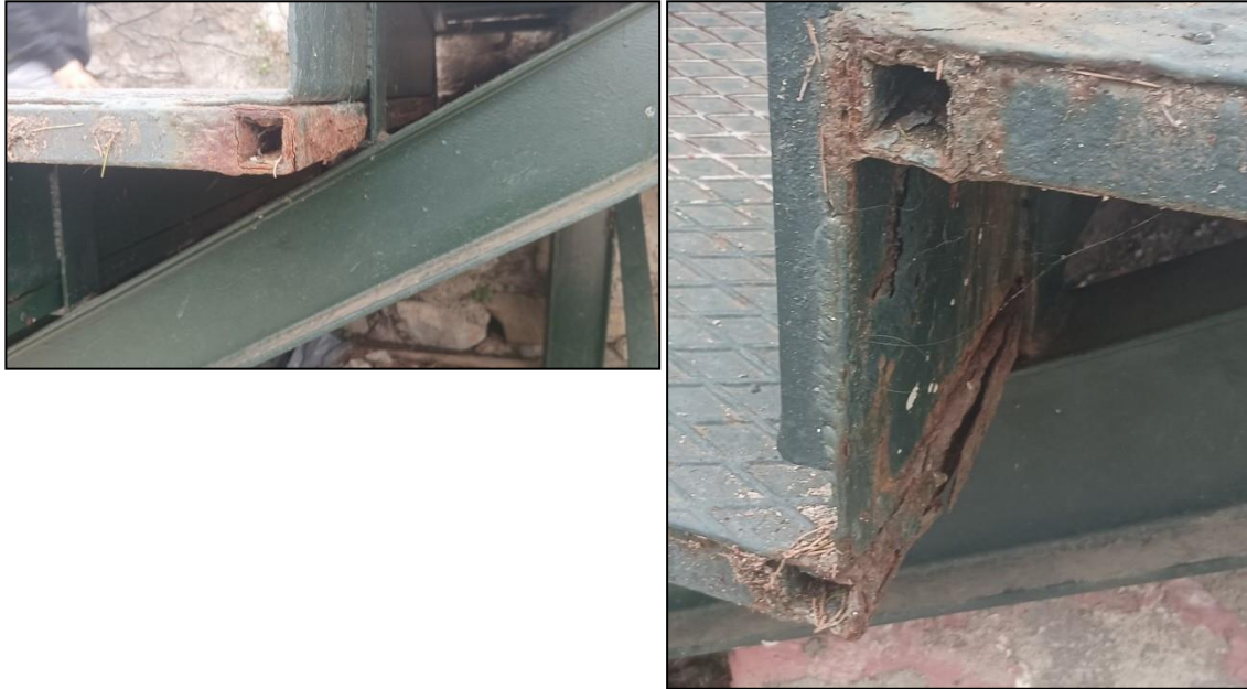
Σκουριασμένο τμήμα μεταλλικής σκάλας
